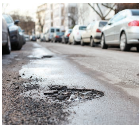
Schadhafte Straße: Deutsche Kommunen müssen Milliarden in ihre Infrastruktur investieren
